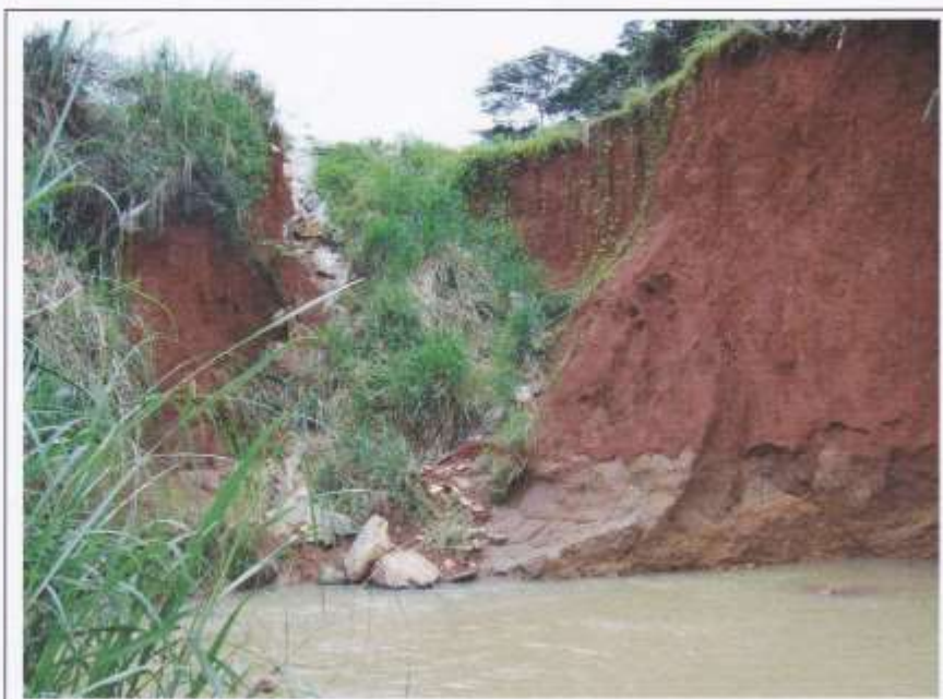
Erosión a Orillas del Río Burunga y Desagüe de la Barriada
