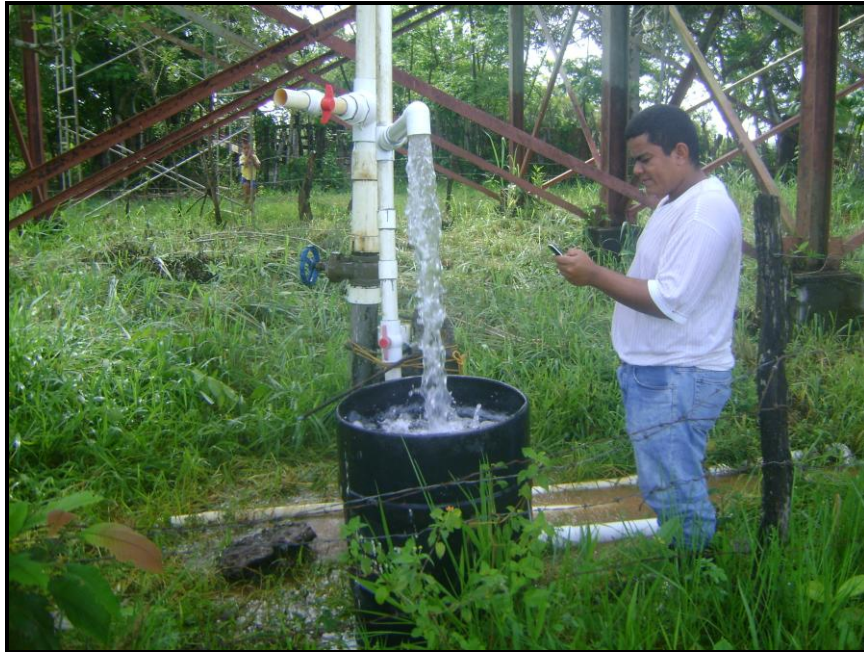
FÍGURA 3 AFORÓ DE LA BOMBA DE EXTRACCIÓN DE AGUA UBICADA EN LA QUEBRADA LA BERRONA
