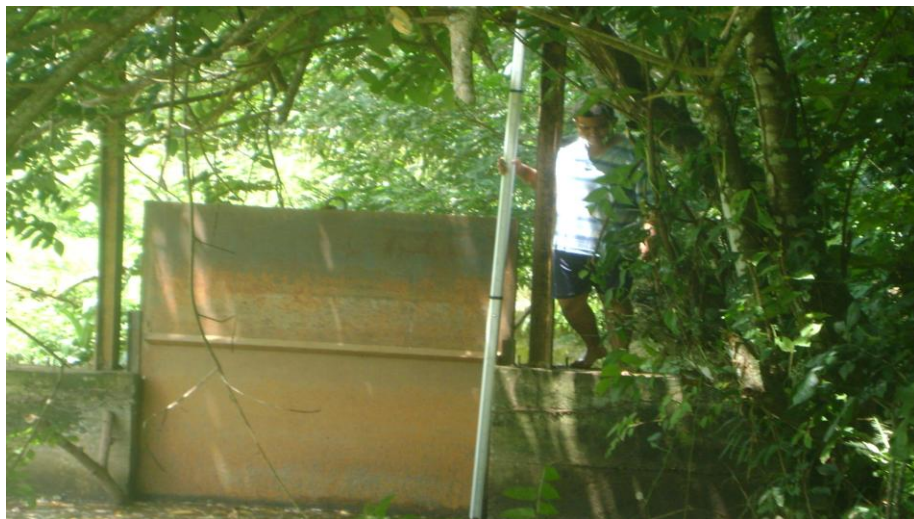
FÍGURA 9: Vertedero Tipo Compuerta con Secciones Rectangulares en la Compuerta 2 en Finca Icaco
