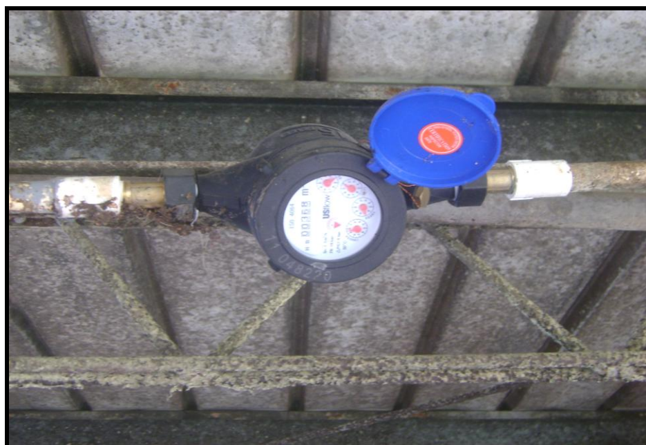
FÍGURA 2 MEDIDOR DE AGUA INSTALADO EN EL PROYECTO PECUARIA
