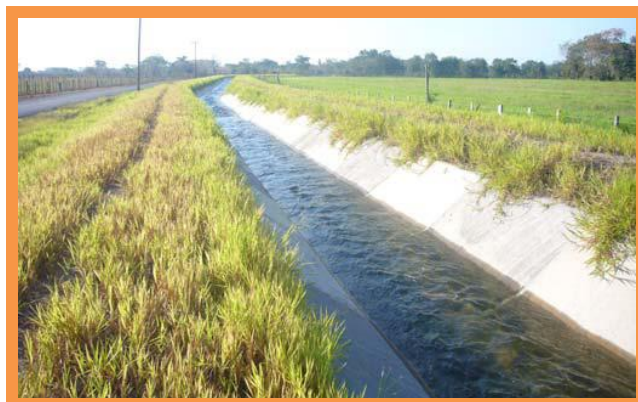
Foto 2: Canal de Riego Remigio Rojas, obra civil. (Pérez Marisol. 2008)
