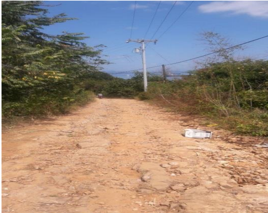
Foto 2 Katherine Sanchez (Carretera al Cerro de la Cruz en mal estado)
