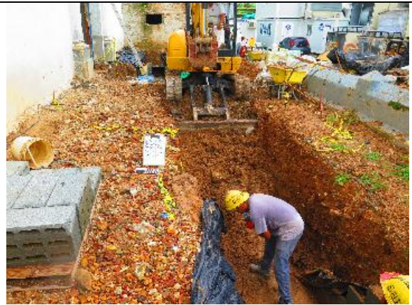
Figura N° 74. Vista general del monitoreo.
