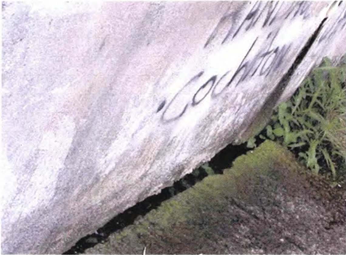
Foto N°11 Las aceras perimetrales de los edificios se encuentran en mal estado, en algunos puntos como se observa en la siguiente foto está levantada. Fuente: Arq. Carlos Quintero.
