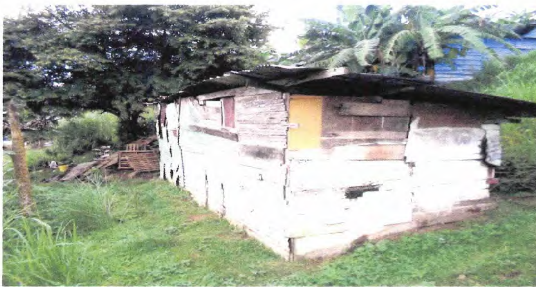
Foto N° 5. Vivienda de madera en total deterioro. Fuente: Arq. Carlos Quintero.
