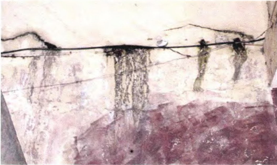
Foto N° 10 Deterioro en la losa, paredes y pasillos de las escaleras por filtraciones. Fuente: Arq. Carlos Quintero
