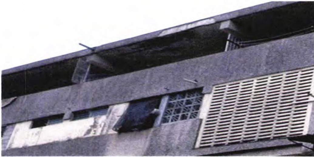
Foto N° 9 El área de los pasillos se encuentra deteriorada por las filtraciones en la azotea. Fuente: Arq. Carlos Quintero.
