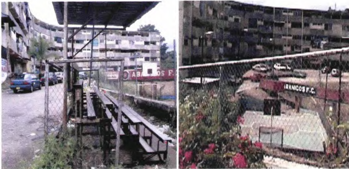
Foto N°17 Cancha de Baloncesto, en total deterioro. Fuente: Arq. Carlos Quintero.
