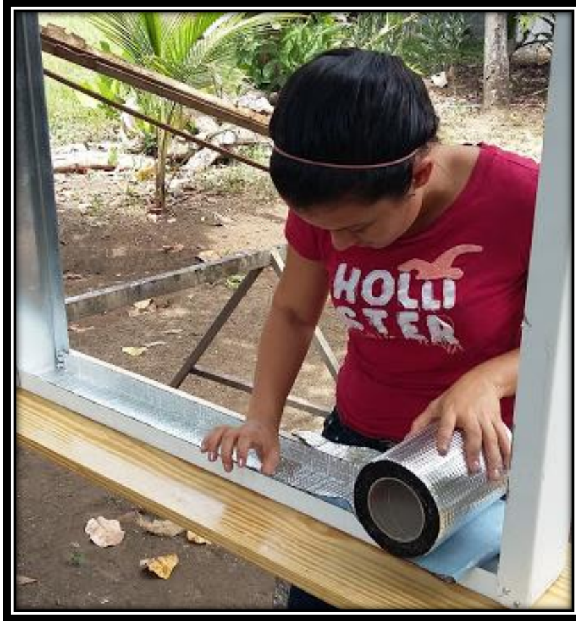
ANEXO N° 13. Colocación de cinta asfáltica en la parte interna del marco
