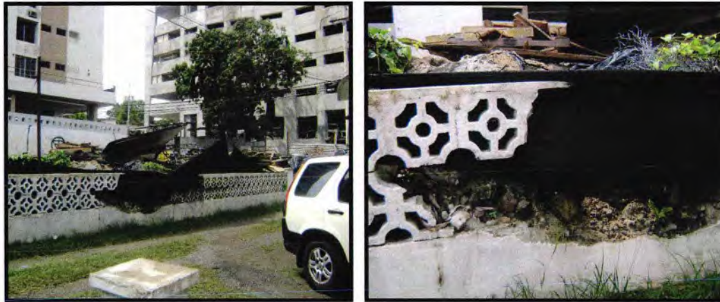
Afectación sufrida en el muro lateral derecho de la vivienda, por movimiento de tierra para construcción de edificio.
