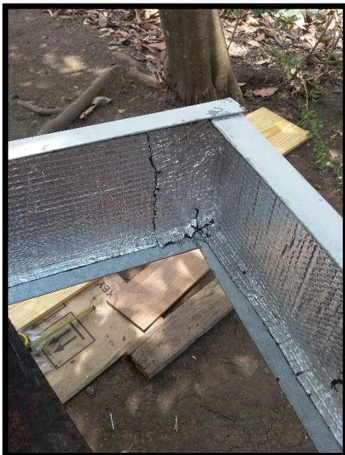
Anexo 14. Cinta asfáltica adherida en la parte interna del marco.
