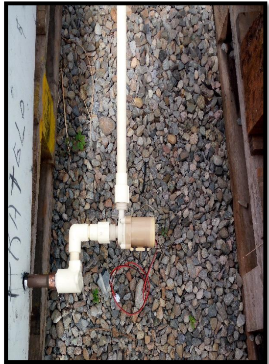
ANEXO 55. Bomba recirculadora
