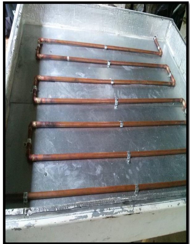
ANEXO 30. Tubería adaptada al colector
