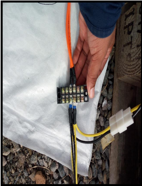
ANEXO 54. Regleta de conexión de componentes auxiliares
