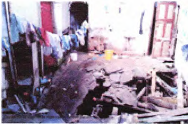
Estado actual de la losa Fuente: La Prensa Octubre 2012
