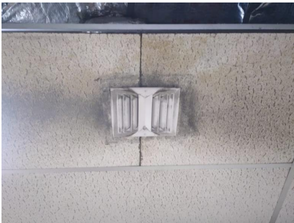
Figura 3. Ductos de aire, edificio de Entomología, planta baja.
