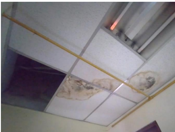
Figura 4. Cielo raso manchado, piso 2, edificio de Entomología.
