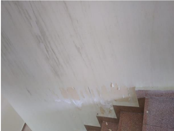
Figura 2. Paredes con humedad y pintura desprendida, edificio de Entomología, escaleras primer piso.
