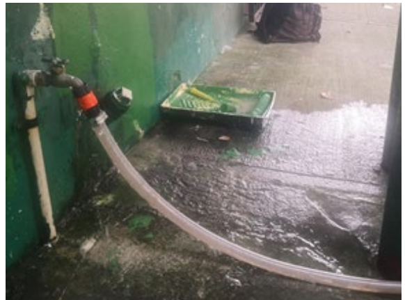
Figura 16. Punto de colecta de agua tratada en el Centro de Salud de Paraíso, corregimiento de Ancón.
