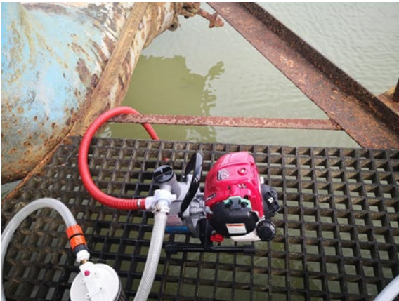
Figura 15. Punto de colecta de agua cruda del lago Miraflores en la planta potabilizadora de Miraflores.
