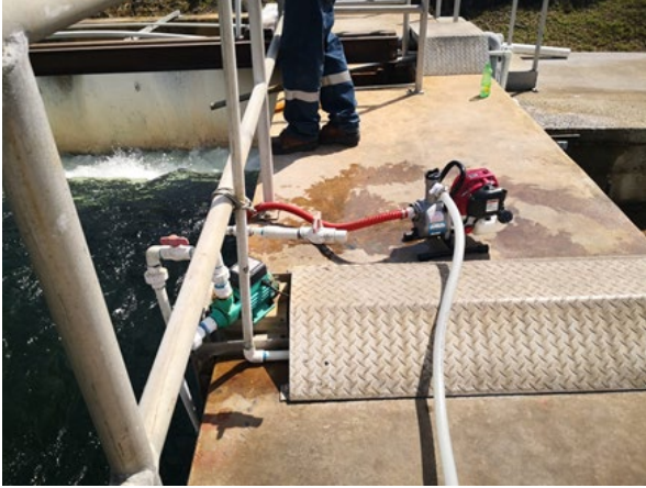
Figura 13. Punto de colecta de agua cruda antes del proceso de potabilización dentro de la planta potabilizadora de Chilibre.
