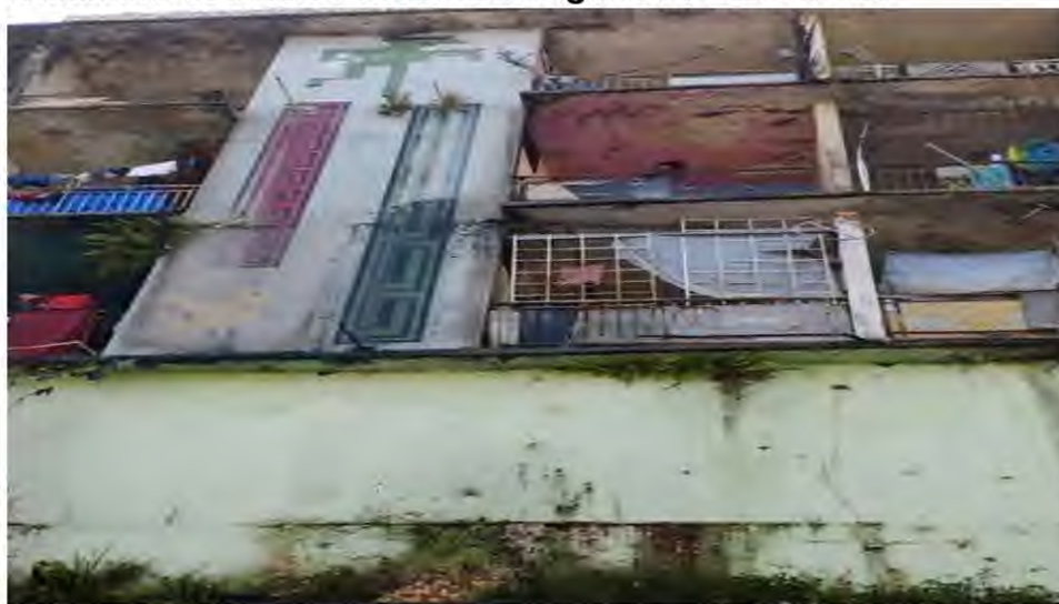
Figura 8. Edificio deteriorado en el corregimiento Calidonia.
