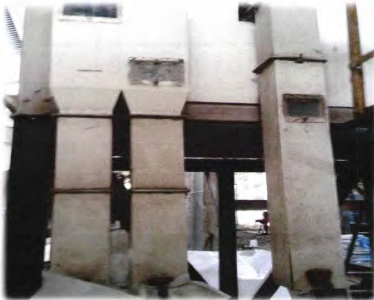
Anexo 19. Compartimientos para la salida de los desechos producto de la limpieza del grano. El Roble –Aguadulce. 2017.
