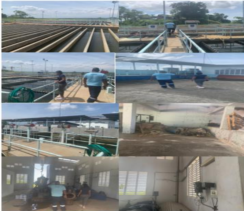
Figura N°42 Infraestructura de la Potabilizadora de Pacora
