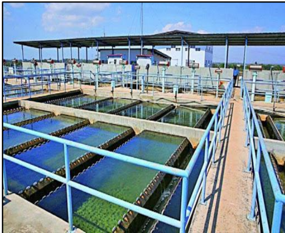
Figura N°23 Planta Potabilizadora de Pacora.
