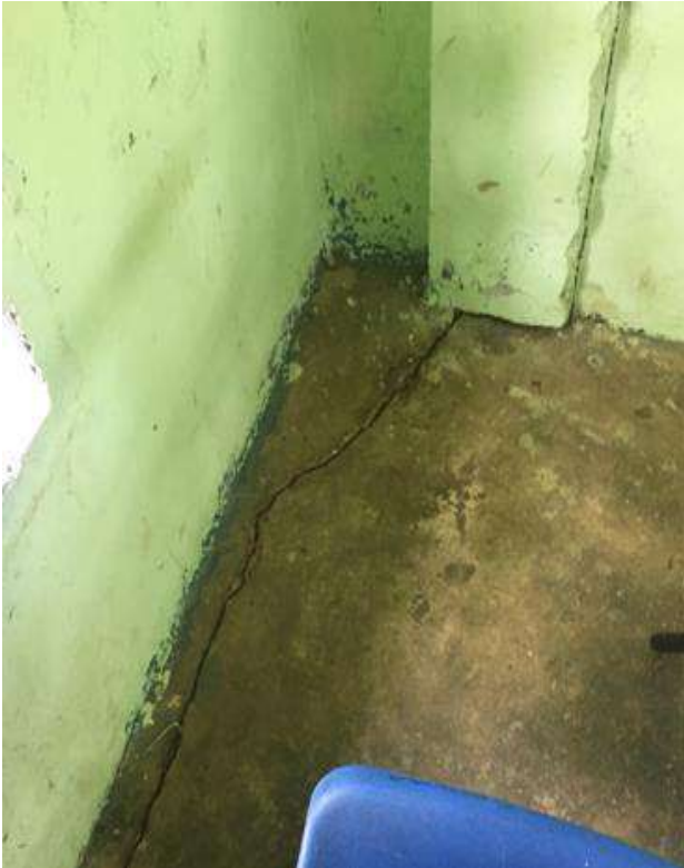
Imagen 40: piso y columna interna de aula de clase afectados por fisuras
