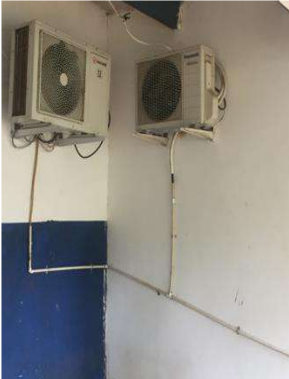
Imagen 47: Ventiladores de aire acondicionado sin verjas protectoras
