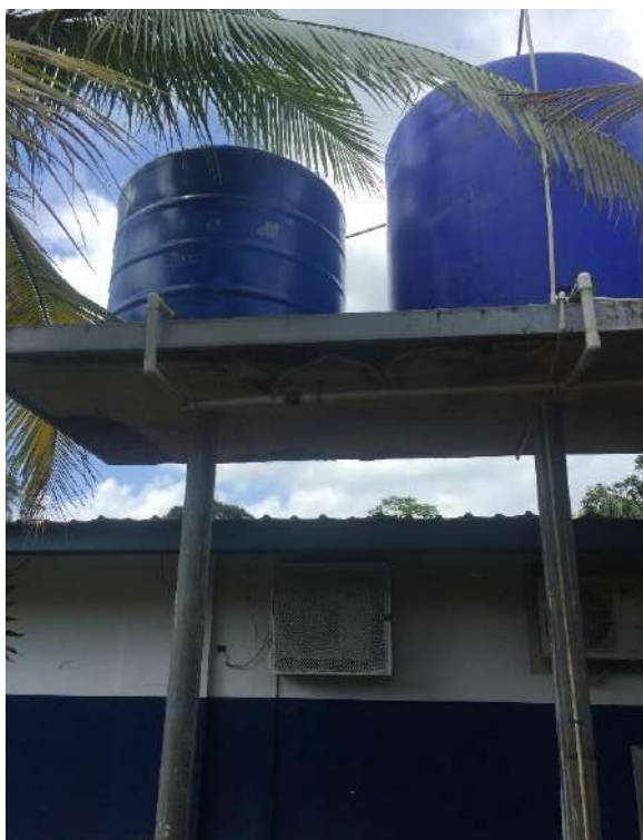
Imagen 53: Tanques de reserva verticales
