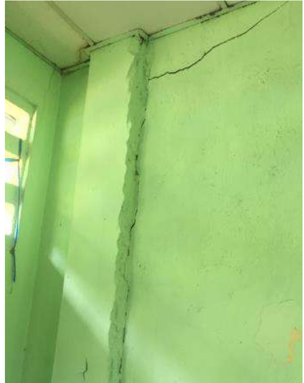
Imagen 41: Rajaduras en columna interna
