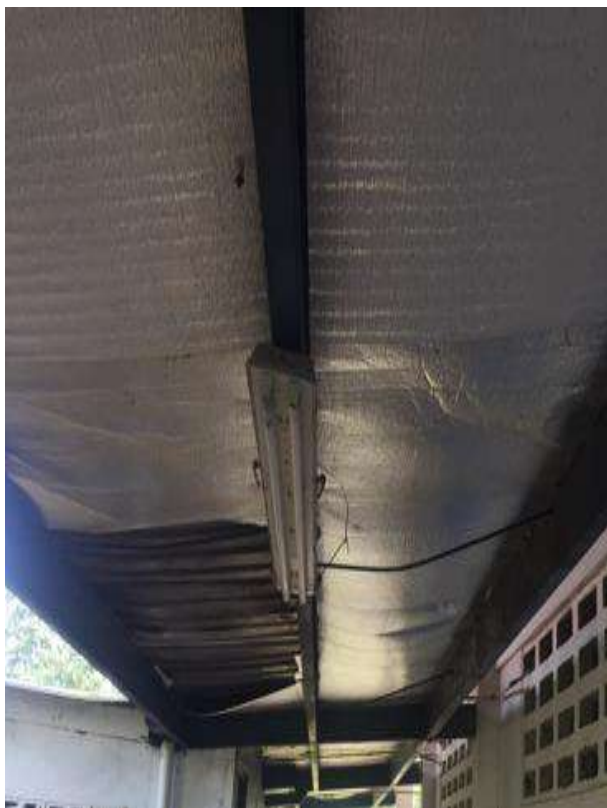
Imagen 38: cielo raso expuesto en pasillo externo de un pabellón
