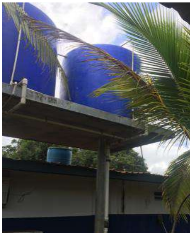
Imagen 54: Tanques de reserva verticales
