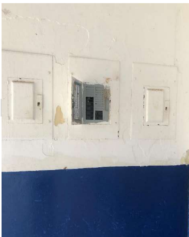
Imagen 49: Paneles eléctricos de aulas y laboratorios
