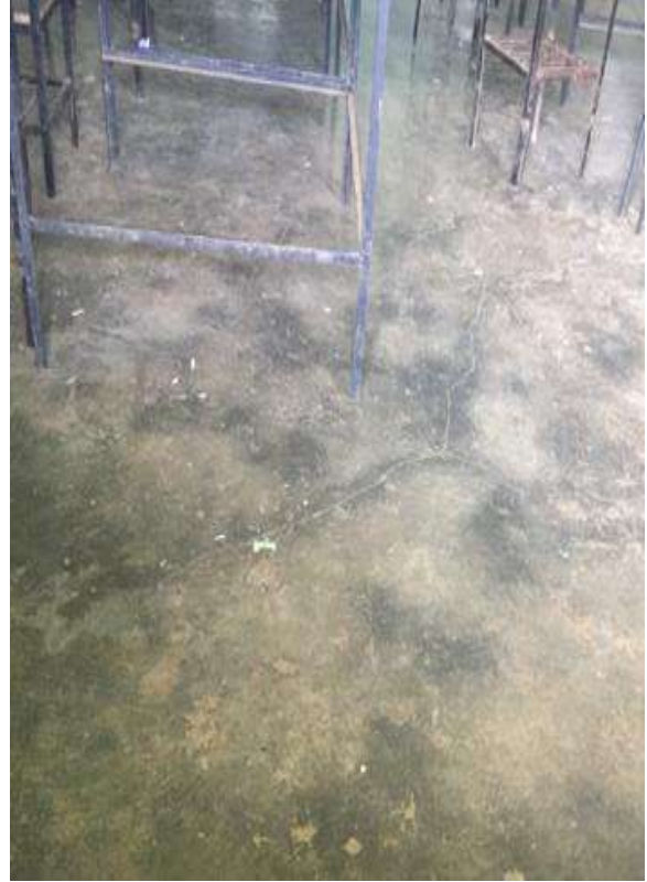
Imagen 46: piso de aula de clase agrietado
