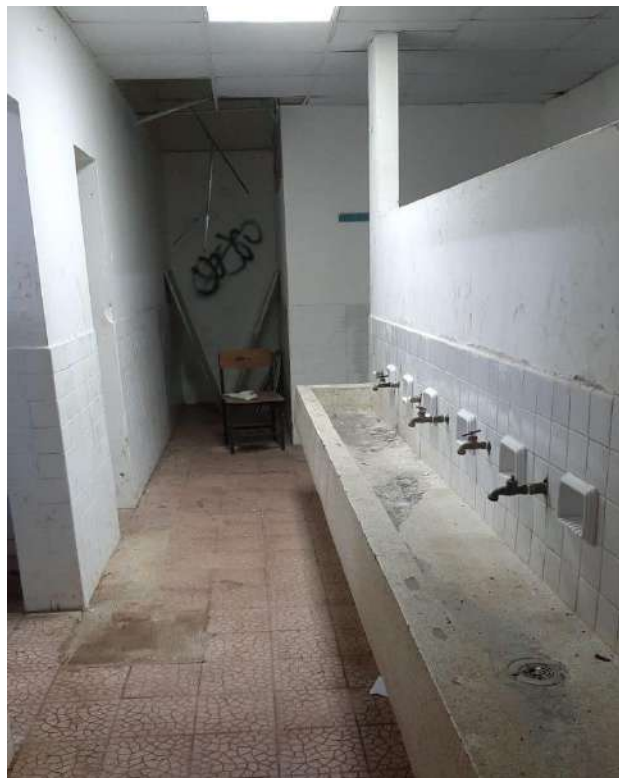
Imagen 81: Área de lavamanos
