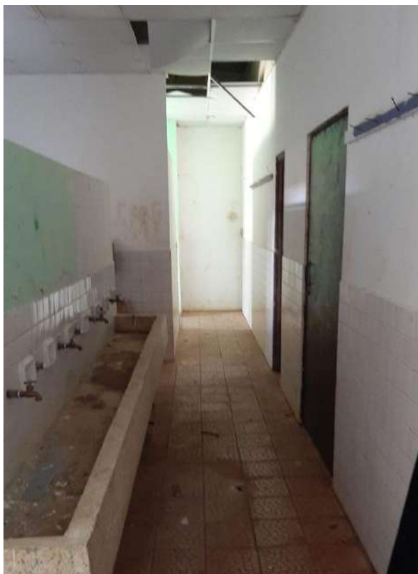
Imagen 82: Área de Lavamanos
