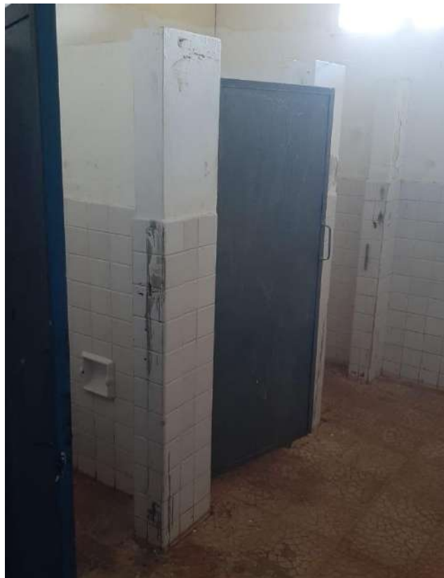
Imagen 83: Área de sanitarios
