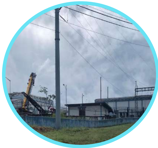
Imagen 14: Planta Potabilizadora de Chilibre
