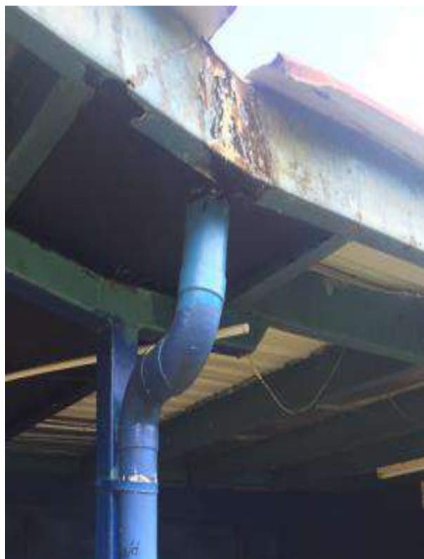
Imagen 52: Canal de desagüe para techo en mal estado
