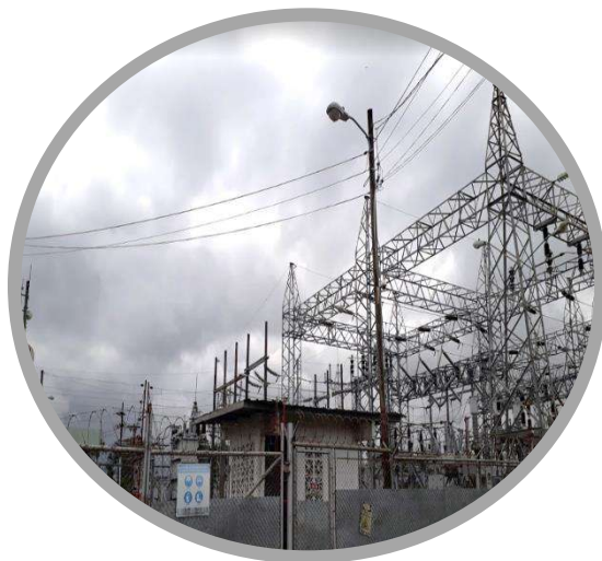
Imagen 13: ENSA, Subestación Chilibre en Villa Unida
