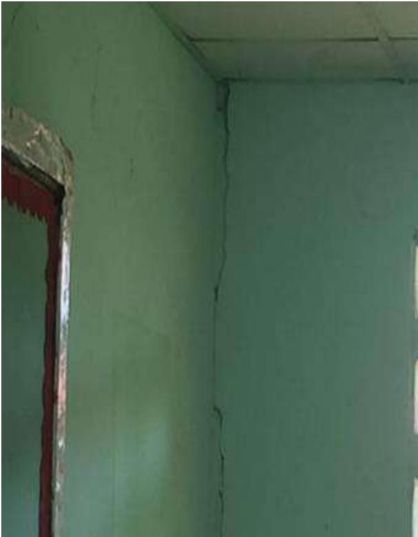
Imagen 42: Fisura en pared de aula de clase
