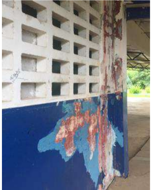
Imagen 43: Acabado afectado por la humedad
