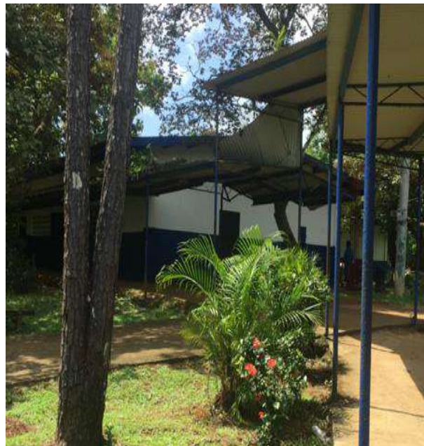
Imagen 37: Lamina de zinc en mal estado
