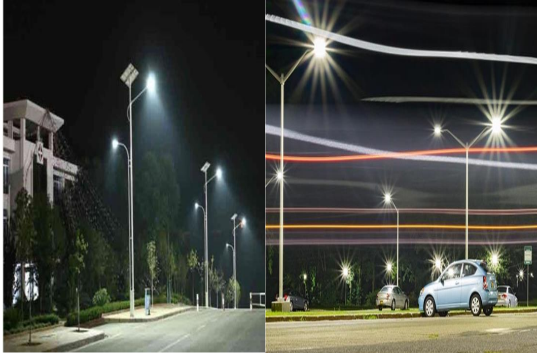
Imagen 15. Luminarias Led para Estacionamientos
