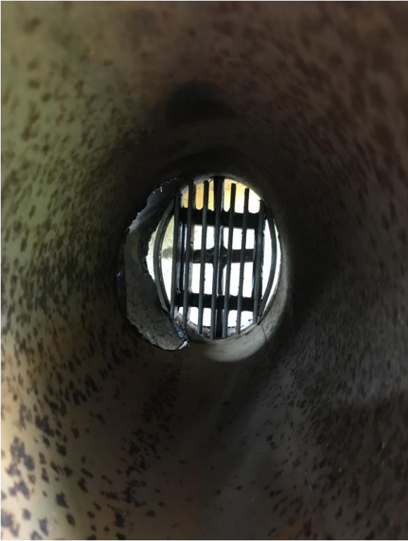
Anexo 5. Cámara de combustión.
