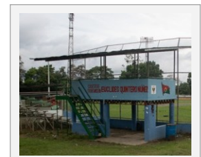
Problemas de diseño y construcción de equipamientos.
