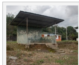
Deterioro general de la infraestructura.
