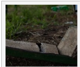
Daños en la infraestructura.
