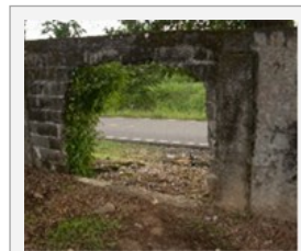
Cerca perimetral en mal estado.
