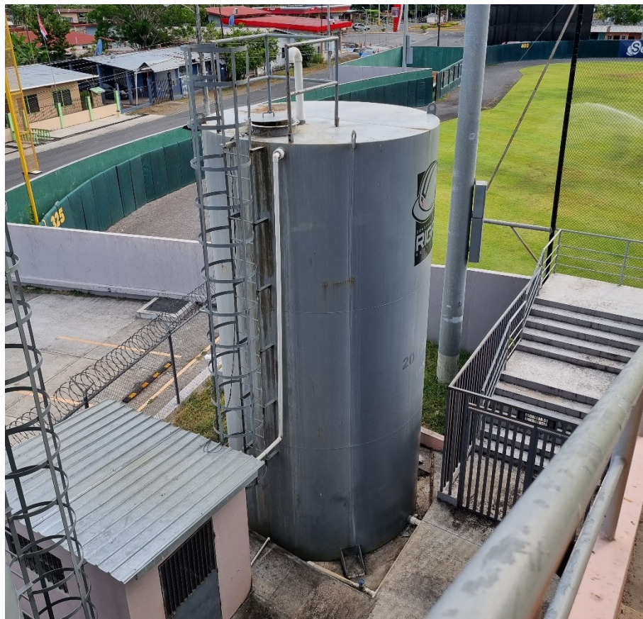
Ilustración 112. Tanque de acero capacidad 25,000 Galones
