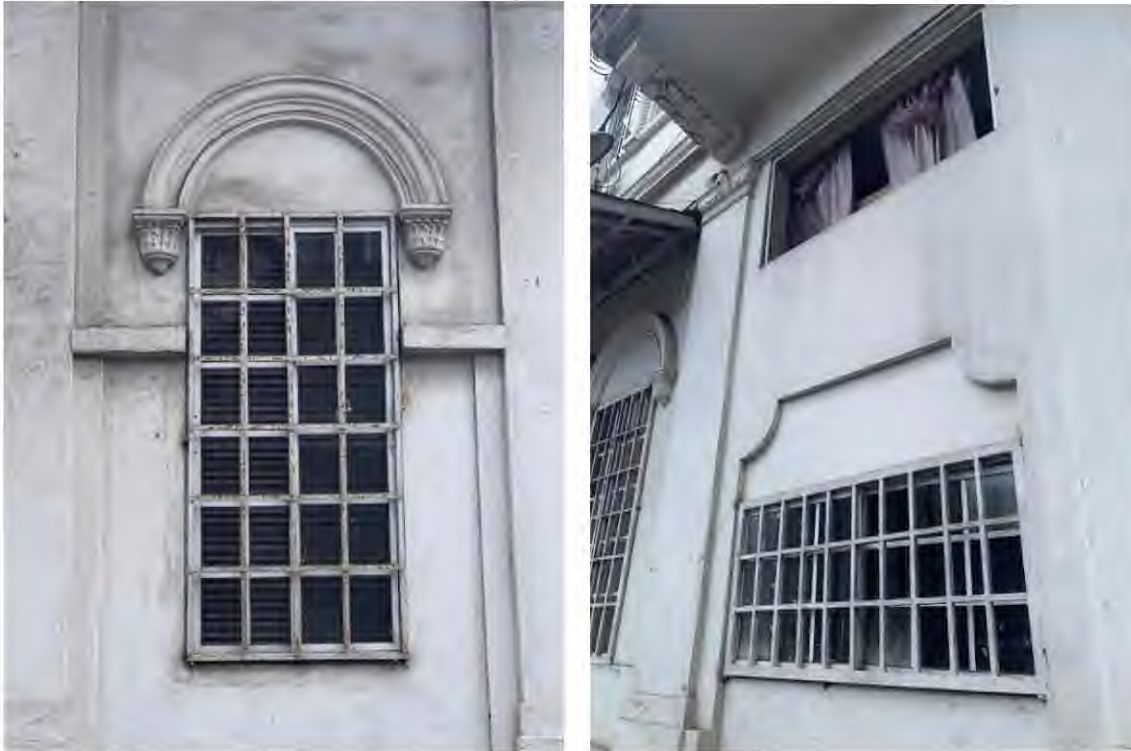
Figura 55. Compendio de fotografías: Estado actual de la fachada posterior
