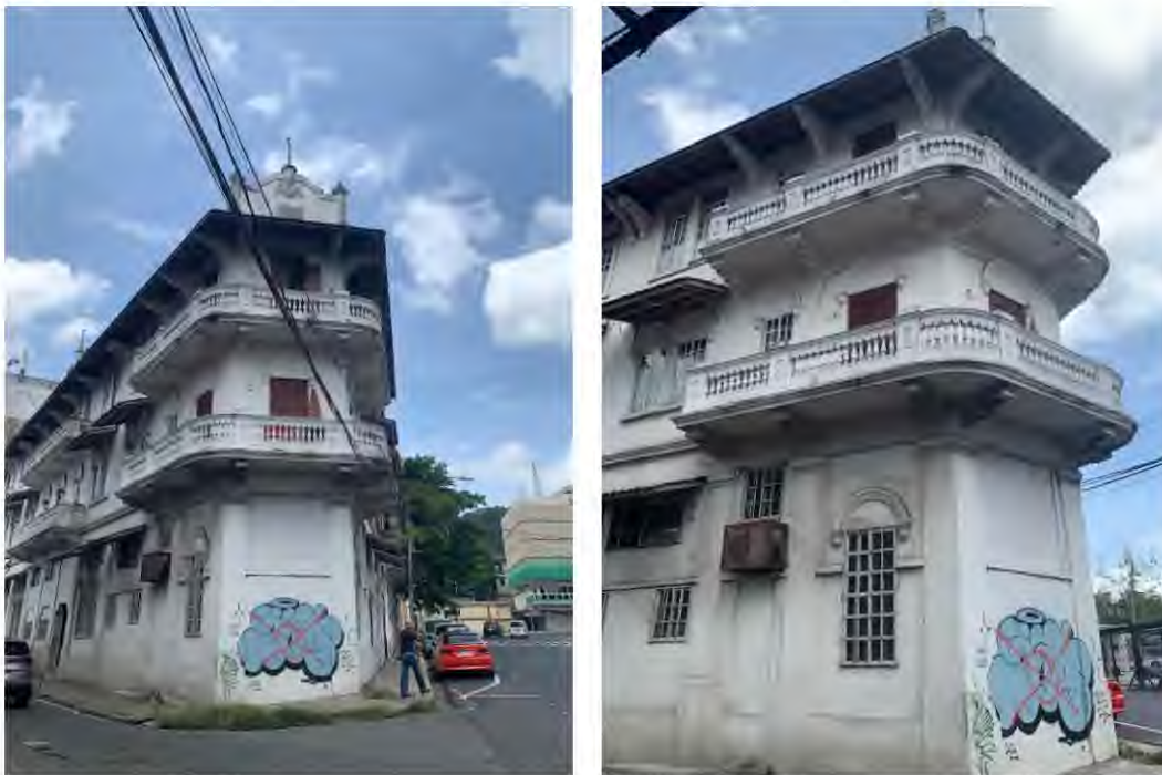
Figura 52. Compendio de fotografías: Estado actual en fachada lateral - Intersección Calle L y Calle Estudiante
