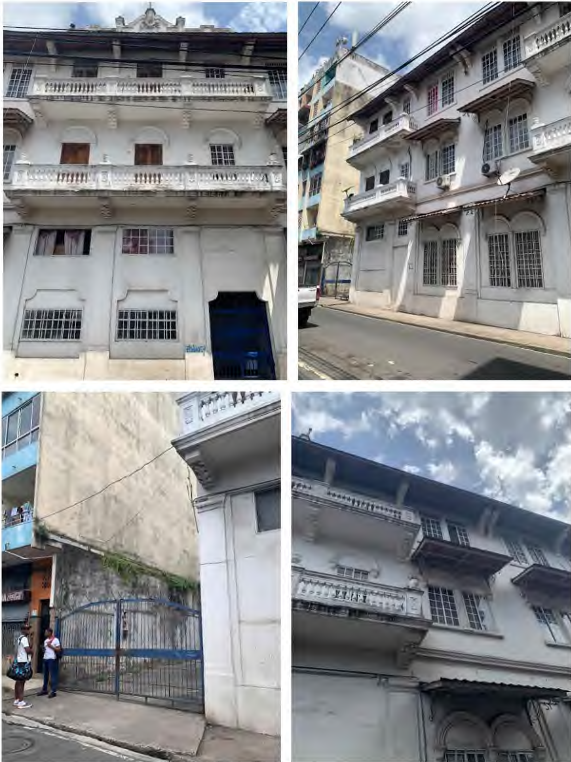
Figura 54. Compendio de fotografías: Estado actual de la fachada posterior
