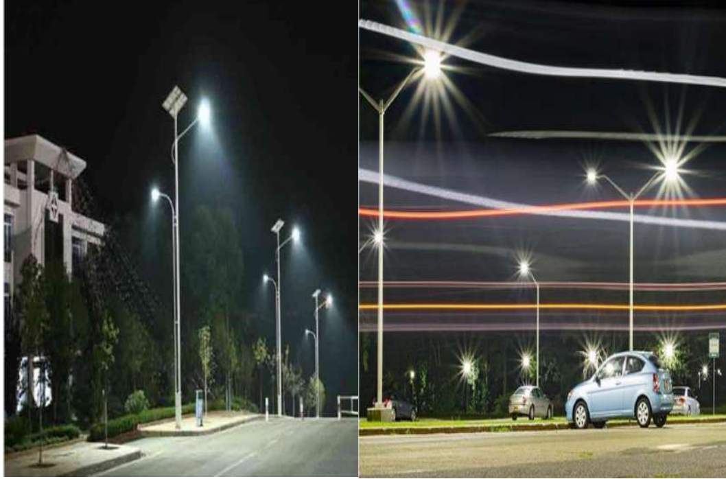
Imagen 15. Luminarias Led para Estacionamientos
