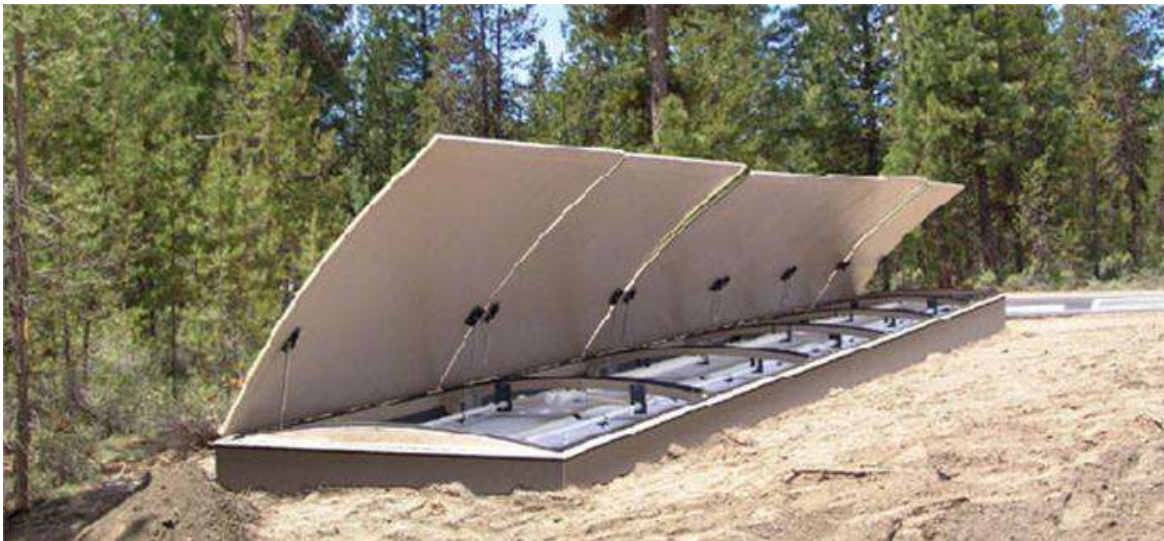
Figura 47. Planta de tratamiento soterrada.
