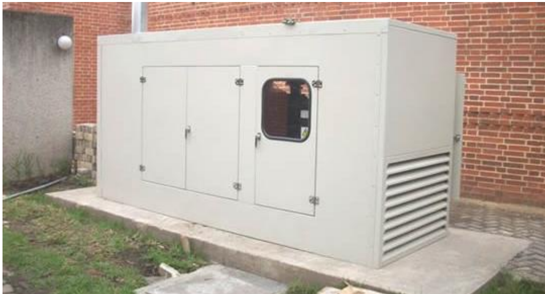
Figura 67. Planta eléctrica con cabina insonorizada. Fuente: Power lift.
