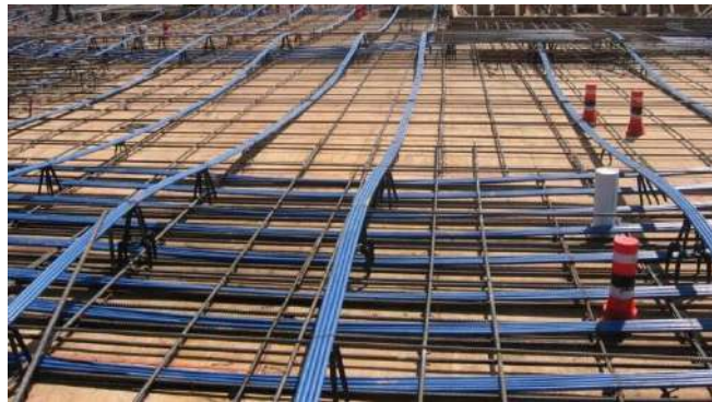
Cables y barras de acero para losa postensada (Fig. 38) Fuente: Página Web: http://www.qooole.com
