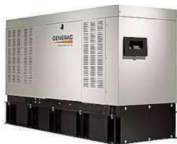
Planta eléctrica (Fig. 41)
