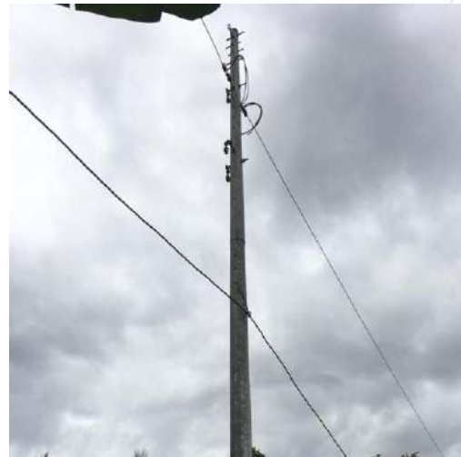
Fotografía 8. Postes de Luz Eléctrica
