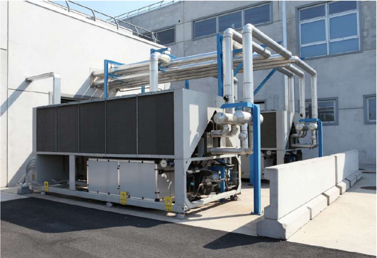
Figura 143. Sistema de aire acondicionado. Fuente: https://generadoresdeenergiaelectrica.com/
