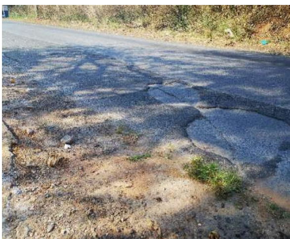
Ilustración 21 Calle en mal estado.
