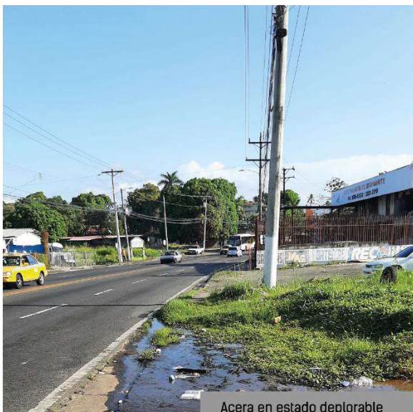
Acera en estado deplorable
