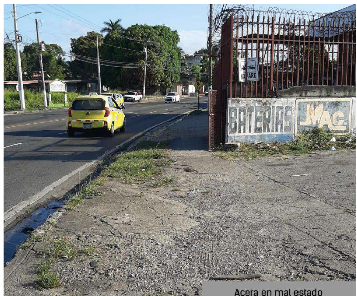
Acera en mal estado
