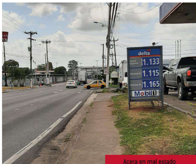
Acera en mal estado
