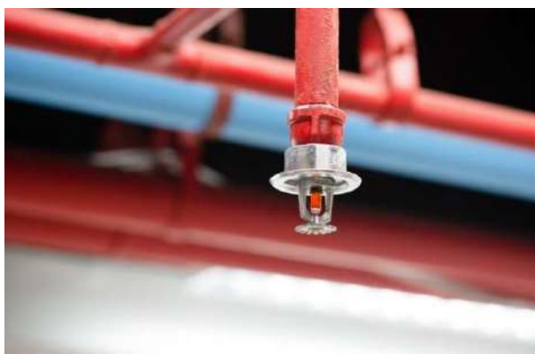
Figura28: Sistema contra incendio
