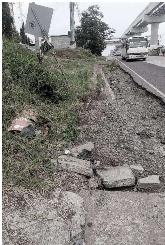
Ilustración 33. Carretera Panamericana. Infraestructura peatonal inexistente. © Yesibeth Ruíz, 2024.
