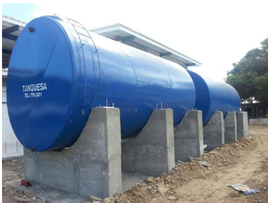
Imagen n.º 15. Tanque de agua de 5,000 galones cada uno.
