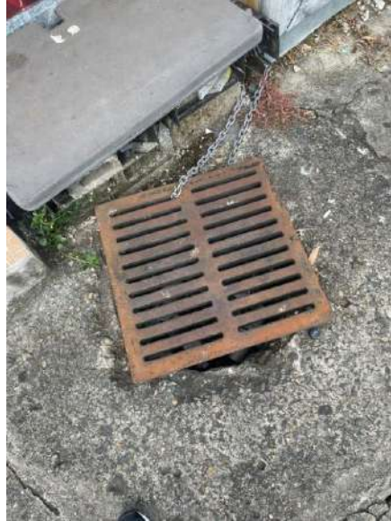
Imagen n.º 9. Huecos de alcantarillas sin tapa
