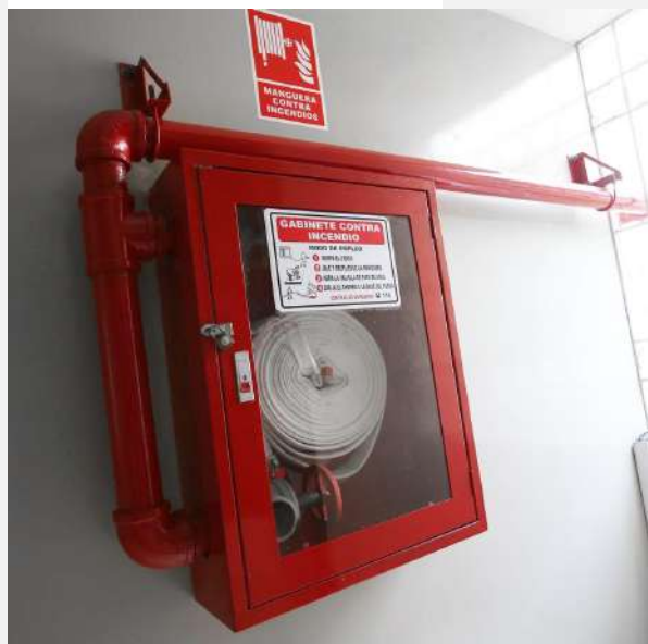
Figura D25 Gabinete contra incendio
