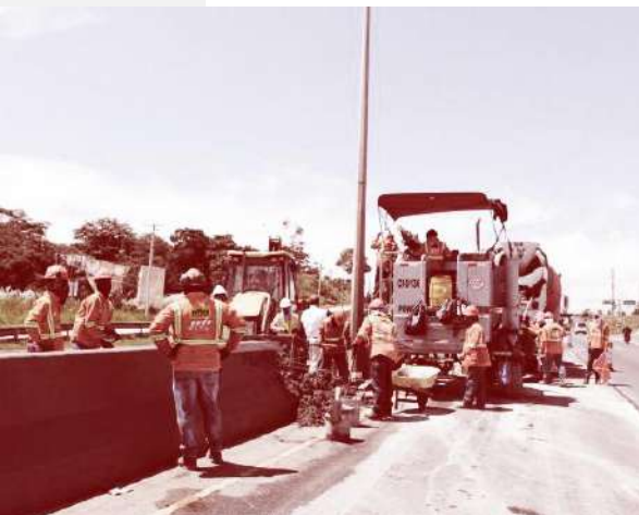
Figura A8 Tratamientos y reparaciones constantes en la autopista Panamá - La Chorrera
