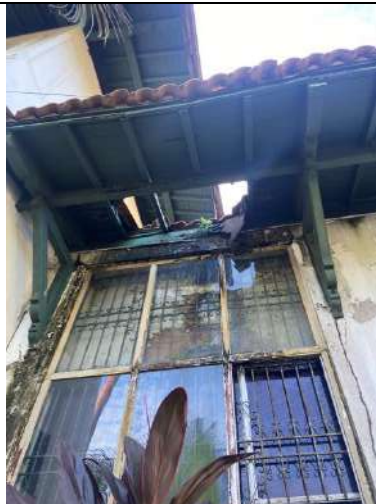
Imagen N.º51 Fachada Frontal, daños en la cubierta.
