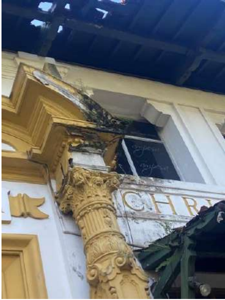
Imagen N.º53 Fachada Frontal, daños en la cubierta y en las columnas externas del arco.
