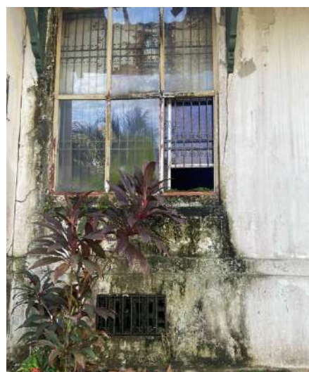
Imagen N.º52 Fachada Frontal, deterioro por humedad en las paredes.
