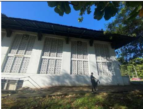
Imagen N.º57 Fachada Este, del área del auditorio, daños por humedad
