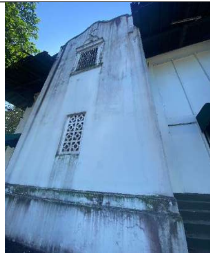
Imagen N.º56 Fachada Frontal, del área del auditorio, daños por humedad.
