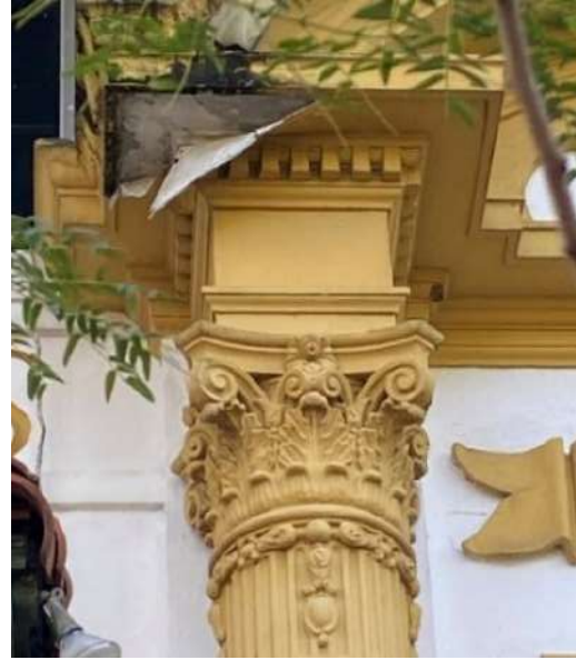
Imagen N.º54 Fachada Frontal, daños en las columnas externas del arco.
