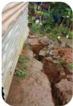
Figura 29. Vistas de afectaciones por deslizamientos y desprendimientos de tierra en la zona de El Mastranto
