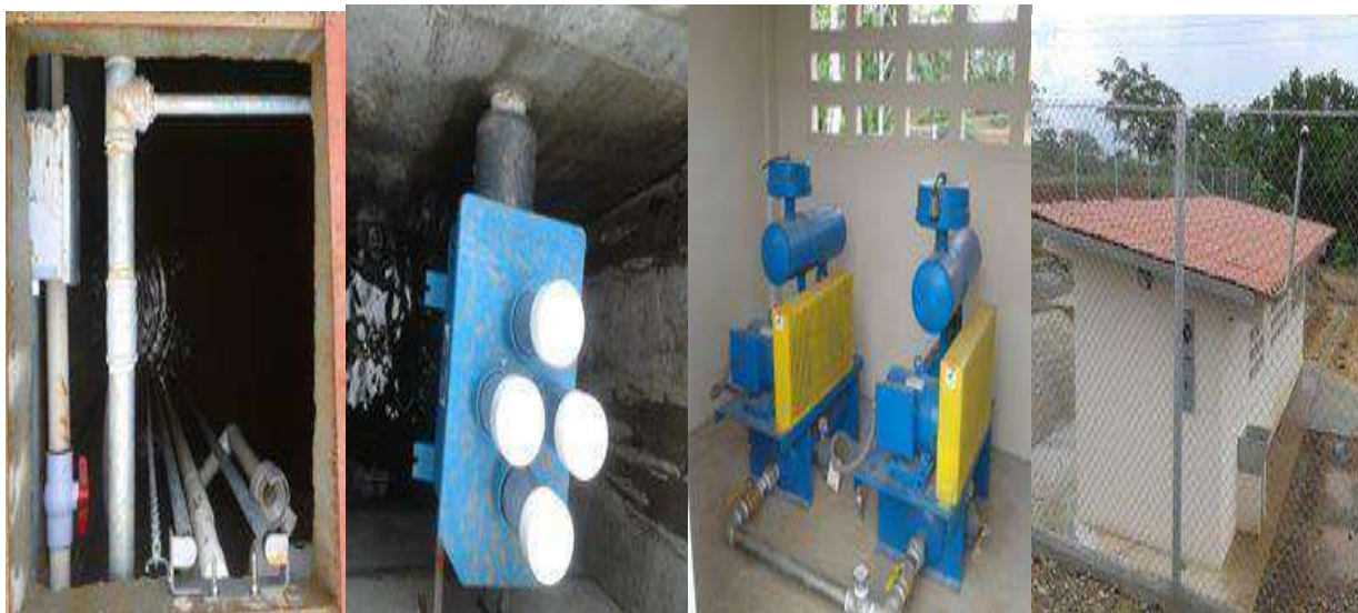
Fig. 21. Planta de tratamiento. https://www.idaan.gob.pa/
