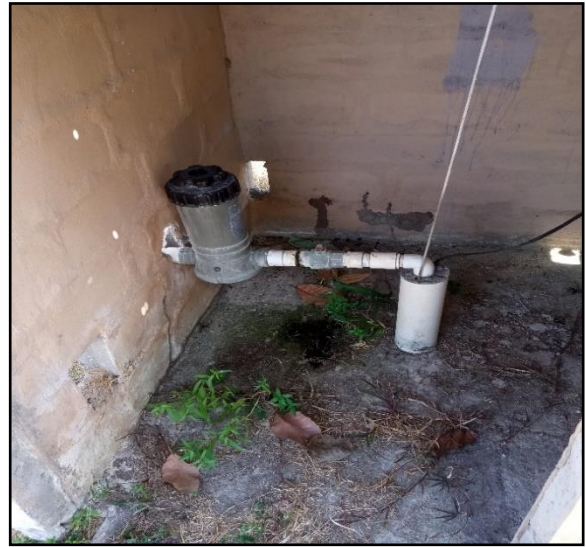
Imagen N.º13. Vista de la bomba de agua Fuente: Elaboración propia (Bomba de agua)
