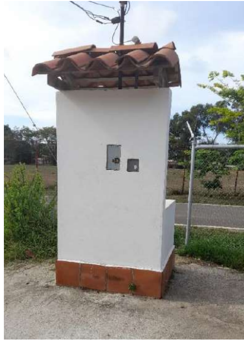
Imagen 14: Tinaquera con panel eléctrico. Foto tomada el 29 de abril de 2022. [Realizado
