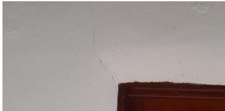
Imagen 21: Grieta en ventana de fachada lateral derecha. [Realizado por autor]
