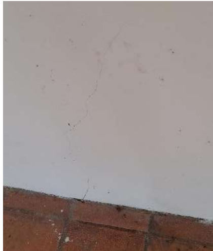
Imagen 20: Grieta en pared de fachada lateral derecha. [Realizado por autor]
