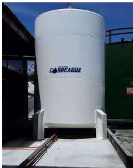
Anexos 4. Tanques de agua. Fuente: (Industrias Correagua, 2024)
