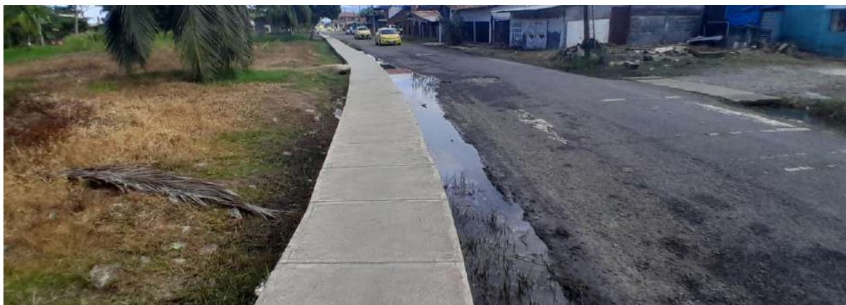
Img 77 Estado de aceras y cunetas frente al terreno en tiempos de lluvia © Wilmer López (2021).
