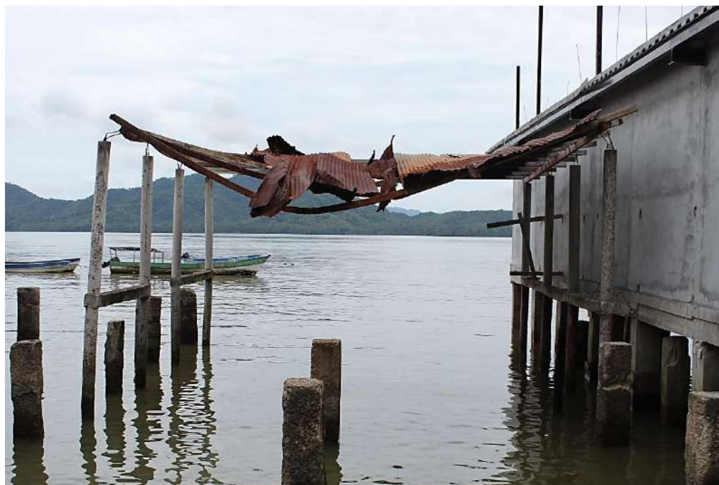
— Fig.7: Una estructura derrumbada que hay sobre la ribera. 2022
