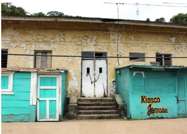
– Fig.10: Antiguo Centro de Salud, edificio abandonado que no se ha demolido. 2022
