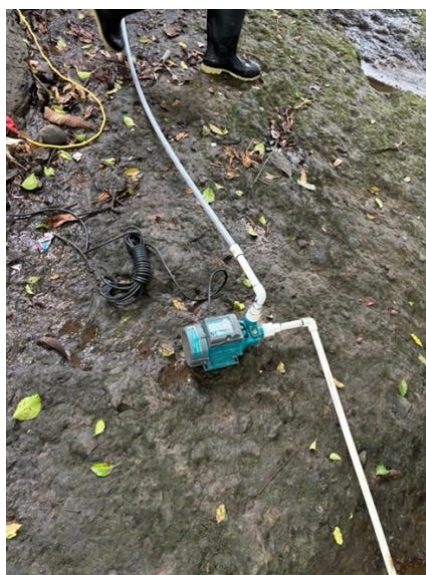
Figura 4. Bomba de extracción de agua en el tramo alto.
