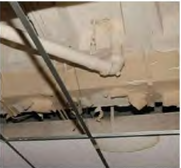
Imagen 1.67. Deterioro de las instalaciones por filtraciones en cielo raso del actual INAM. Fuente: La Estrella de Panamá (2018).
